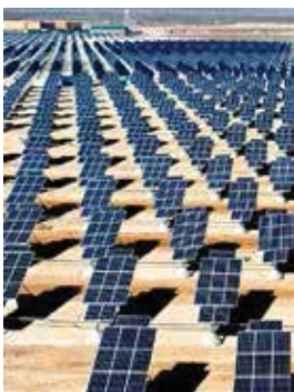
Los datos de radiación solar junto otros parámetros meteorológicos son fundamentales en las fases de implantación de un huerto solar.
